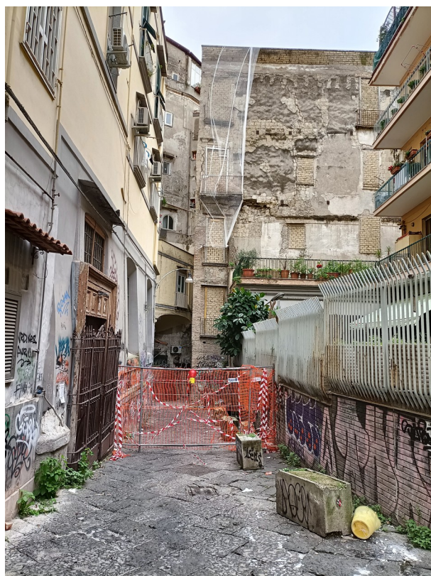
Foto 2 – rete di parziale contenimento applicata in data 28/01/2023
