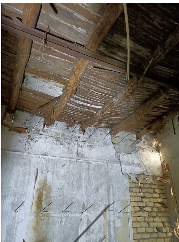
Foto 8 – solai lignei degradati
