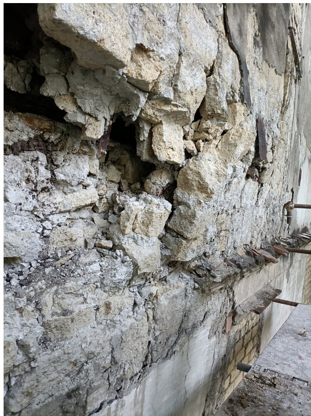
Foto 5 – particolare dissesto facciata
