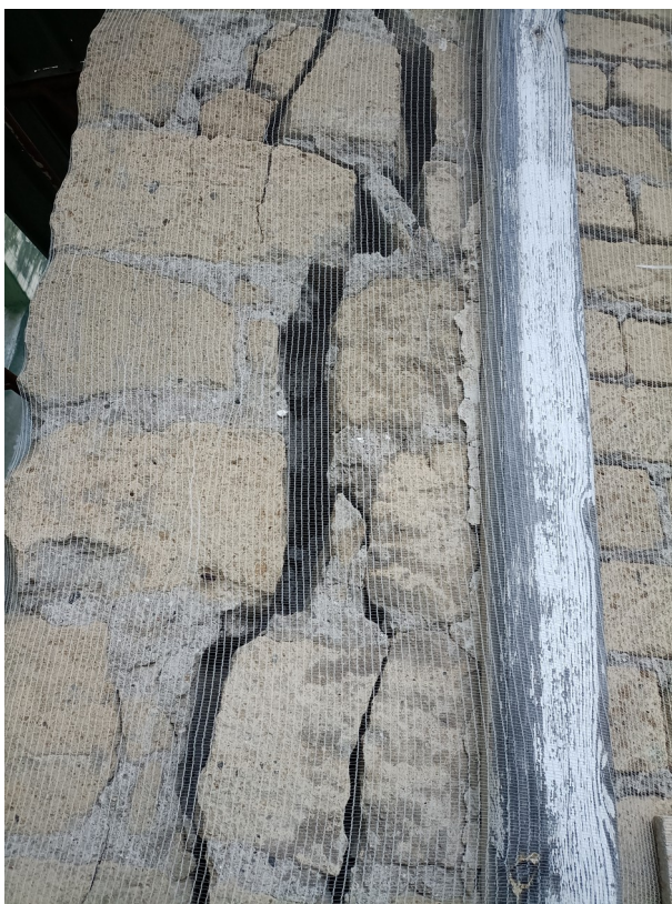
Foto 4 – particolare dissesto cantonale
