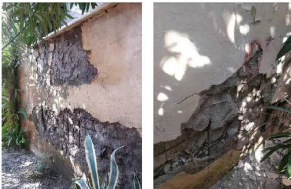
Figura 14 - Rete metallica annegata nell'intonaco e conseguente distacco
