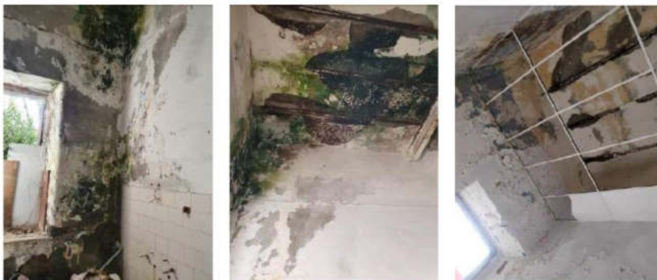
Figura 13 - Presenza di infiltrazioni e umidità, assenza di infissi esterni, controsoffitti crollati e solai in avanzato stato di degrado.
