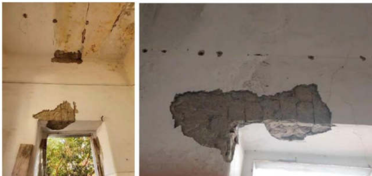
Figura 11 - A sinistra Connessione Parete-Solaio nella parete SUD e architrave - A destra l'architrave nella parete Nord
