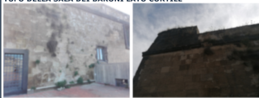
INTERVENTO N°05 INTERVENTO SULLA PARTE ALTA DELLA MURATURA ESTERNA IN TUFO DELLA SALA DEI BARONI LATO CORTILE
