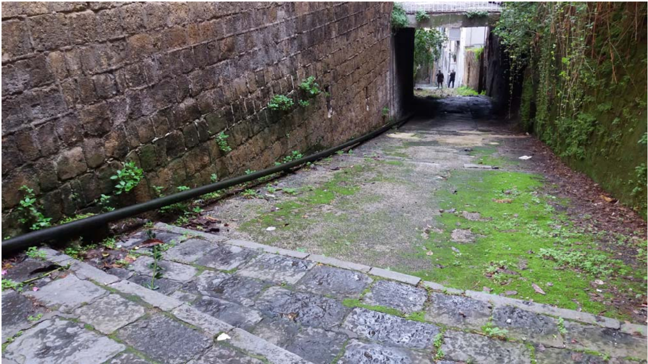
Figura 5 - Salita Caciottoli – degrado e inerbimento dovuto anche all'assenza di drenaggio
