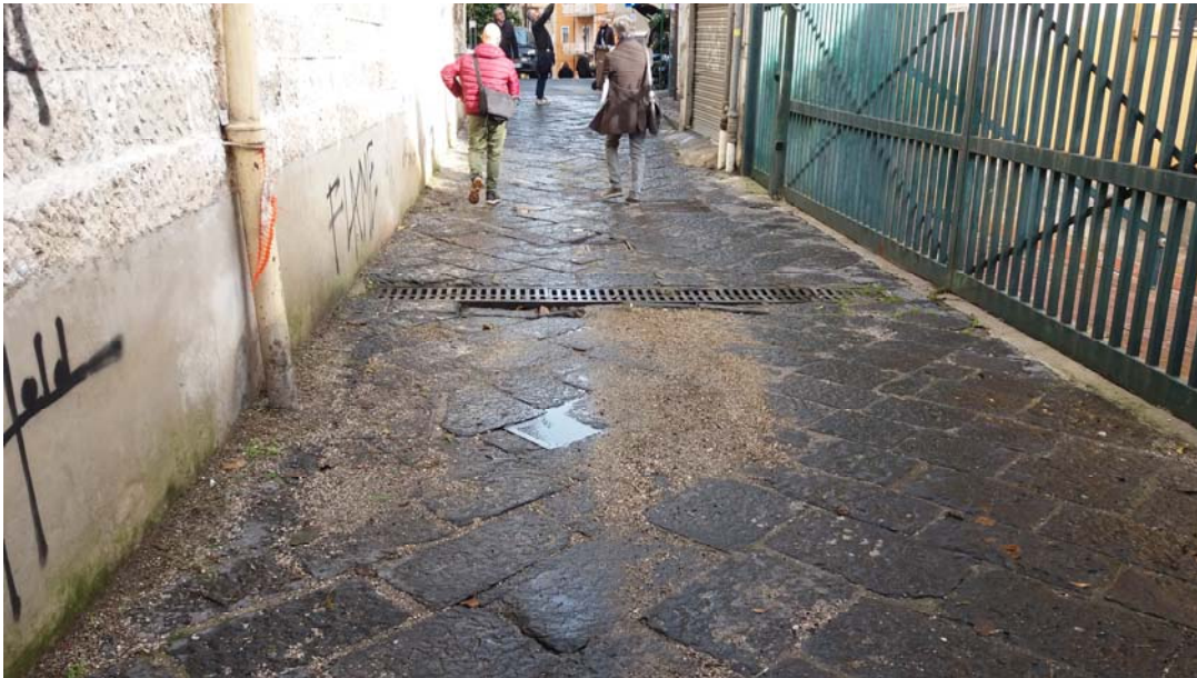
Figura 3 - Salita Caciottoli – accumuli e ristagni in corrispondenza di pavimentazione degradata
